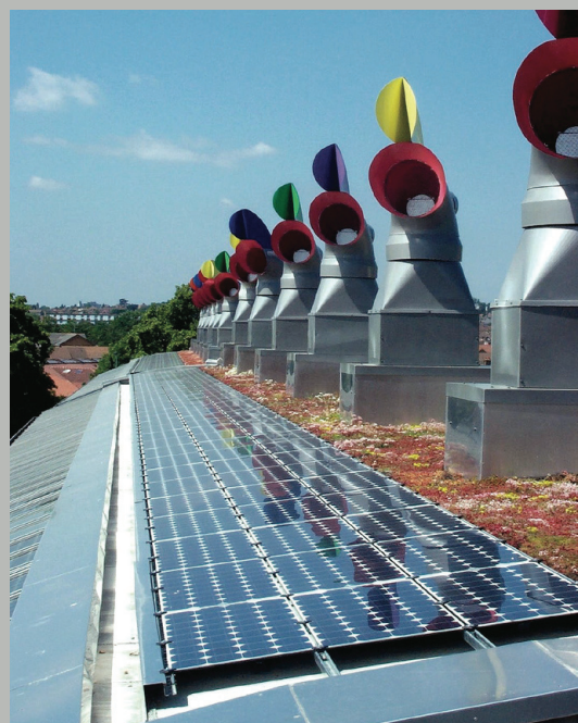
Image 55. Panneaux photovoltaïques et prises d'air.
