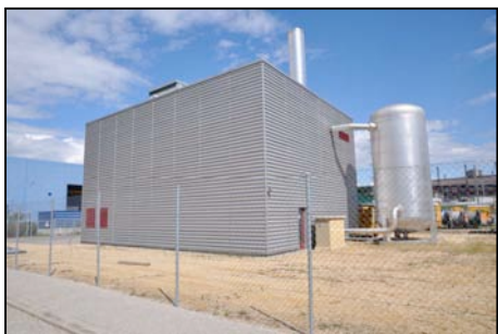
Figure 29. La centrale de pointe sur le site de Malley.
