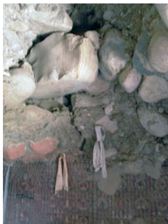
Photo 50 : Danger d'effondrement dû à une fissure dans une grotte de Saspol.
