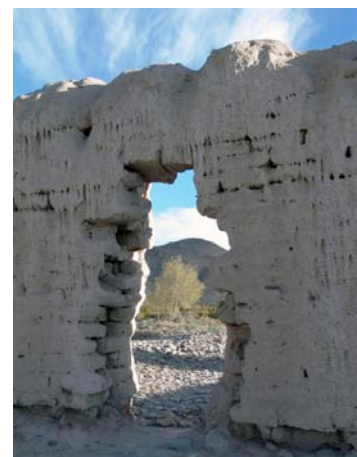
Photo 40 : Dégâts dus au manque d'entretien et à l'altération climatique.
