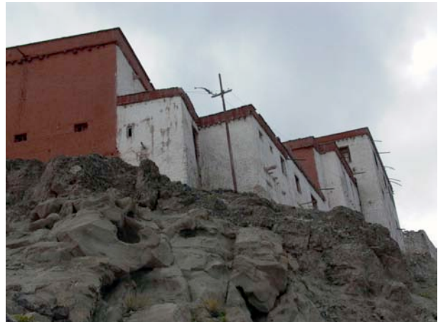
Photo 59 : La couche gréseuse gris clair, au premier plan, a tendance à s'affaisser sous la couche conglomératique gris foncé au deuxième plan. Ce qui a pour conséquence de provoquer des fissures dans les bâtiments sommitaux.
