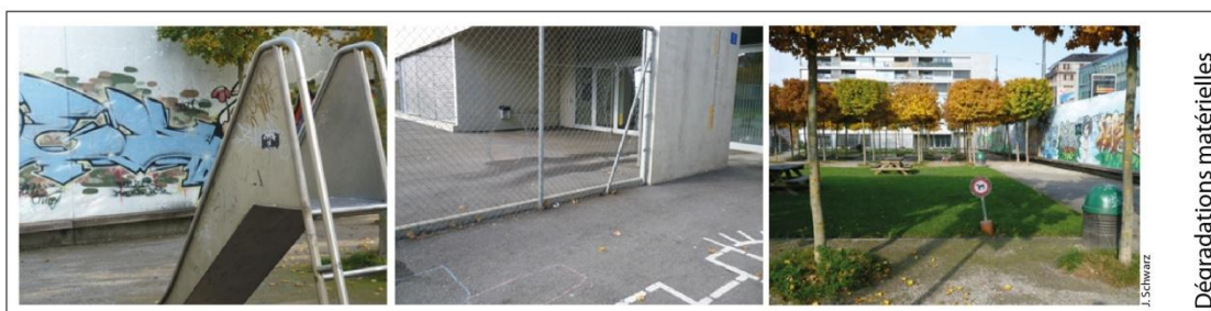
Figure 62. Etat des lieux du parc de la Brouette: dégradations matérielles, Source: J. Schwarz, 2011
