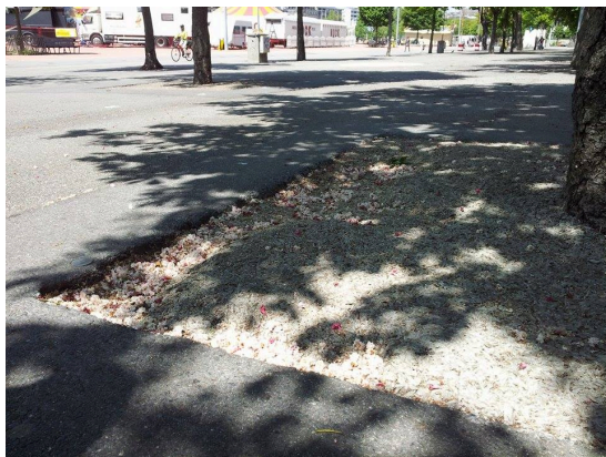
Figure 42 : Revêtement entourant les arbres & ornières. Source : Louis Rochaix
