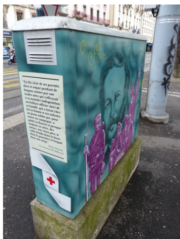
Figure 53 : Borne électrique. Source : Louis Rochaix
