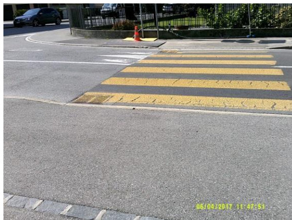
Figure : 54 passage piétons viale Motta - sécurité
