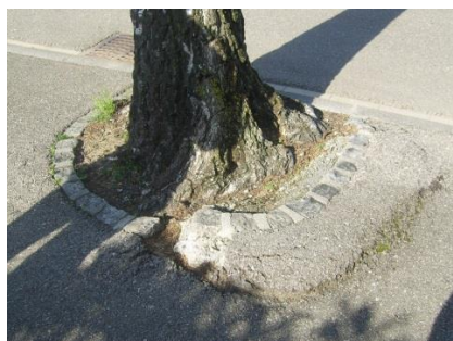
Figure : 46 trottoir cassé par des racines - sécurité
