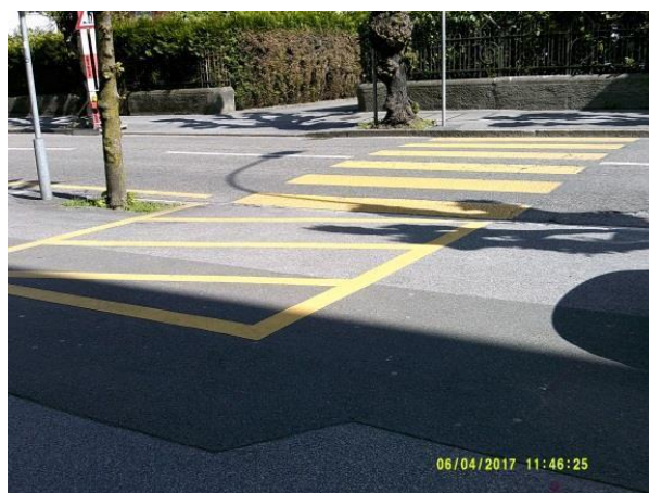
Figure : 56 passage piétons viale Motta - sécurité
