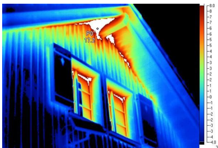
Fig. 34 : Exemple de visualisation d'un phénomène thermique par échelle colorimétrique (Lindenberg Energie, 2018)
