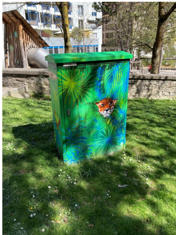
Figure 52 : « Street art » sur boîtier électrique Source : Auteur, avril 2021
