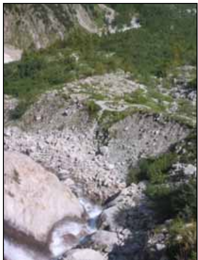
Figure 50 : Ravinement par la Reuse de l'Amône de la moraine dans le secteur ANE04_Da.
