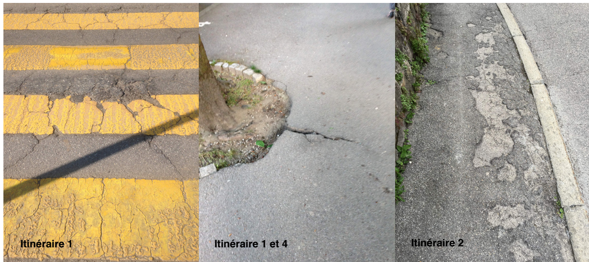
Photo 28 : Exemples de vieillissement des infrastructures [Brancato, 2015]
