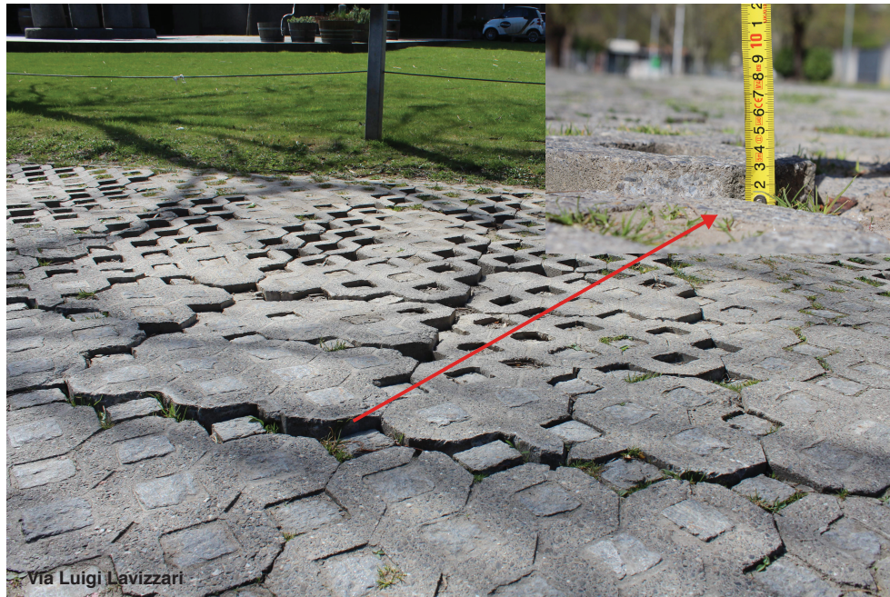
Photo 9 : Problème de niveau du sol [Brancato, 2015]
