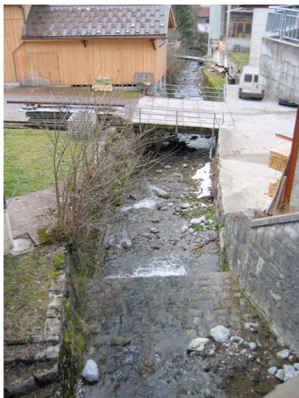
Photographie 16 : La Leyvra canalisée : murs, seuil, radier. Bâtiment en rive gauche dont les fondations servent de mur de rive au torrent
