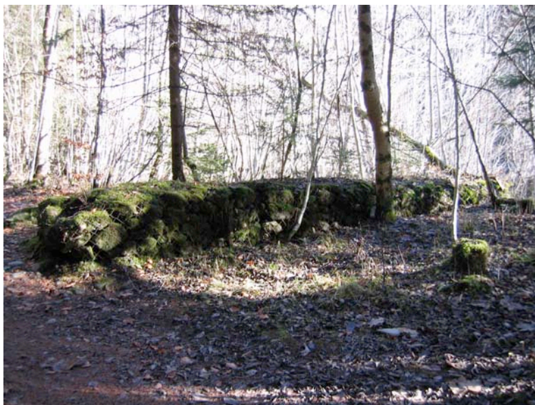
Photographie 11 : Épis en gabions dans la forêt loin de la berge de la Sarine
