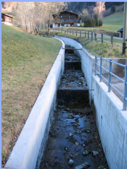
Photographie 9 : Cunette en béton avec seuils en escalier sur le ruisseau de la Vénérie en amont de la route cantonale
