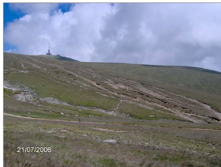
Figure 46 : Ravins apparus le long de fossés des travaux d'entretien en contrebas du relais de Costila
