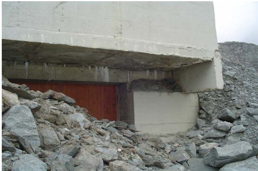
Figure 59 : Les fondations de la station de départ du téléphérique du Mont Fort sont visibles sur près de 2m. C'est une des conséquences des mouvements importants que subit la moraine.
