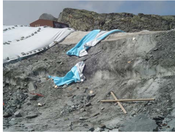
Figure 39 : Dégâts suite à une tempête de foehn
