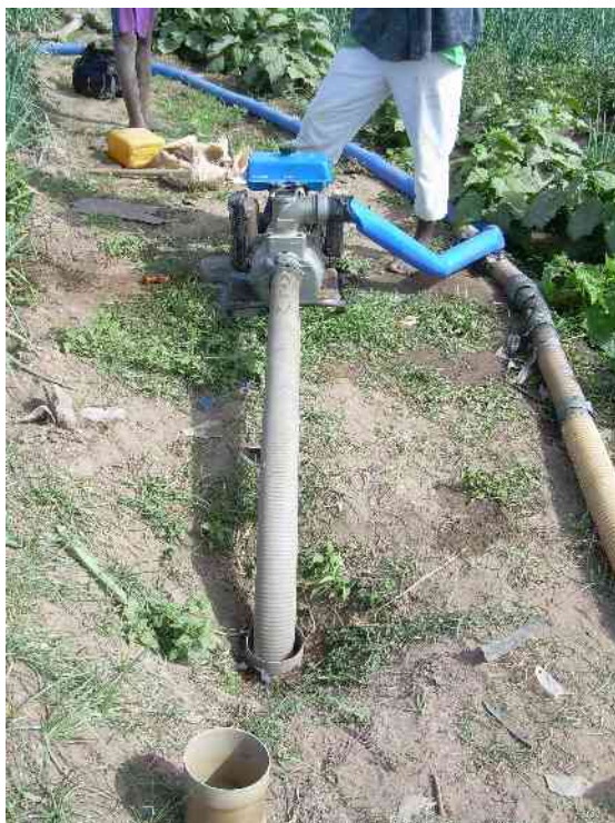
Photo : captage de l'eau par forage PVC – tuyaux et motopompe, zone périurbaine Gaya Source : J.Cochand, enquête de terrain, 2006-2007
