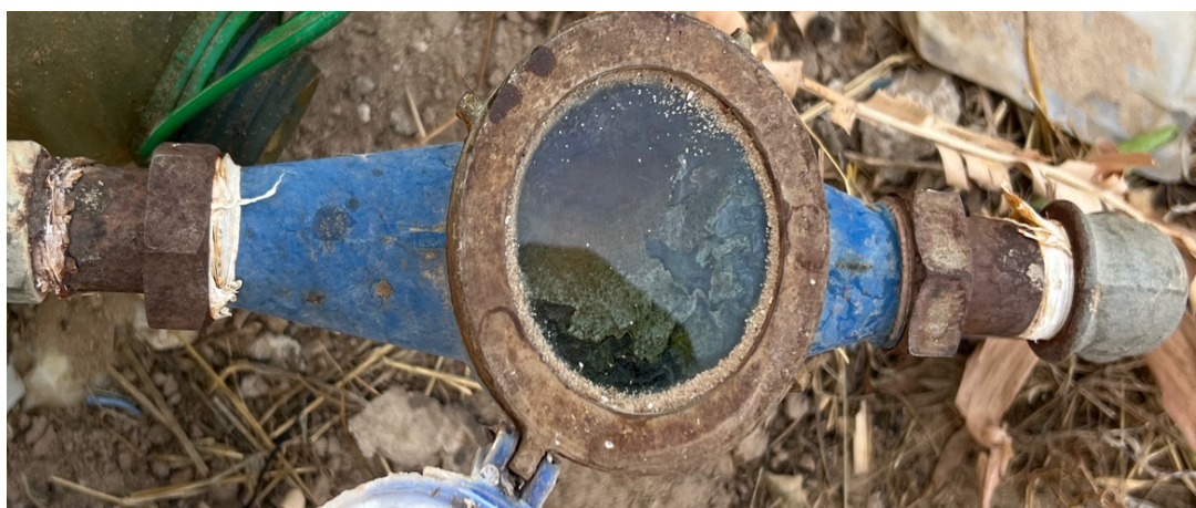
Figure 19 : État d'un compteur d'eau à Taïba Ndiaye
