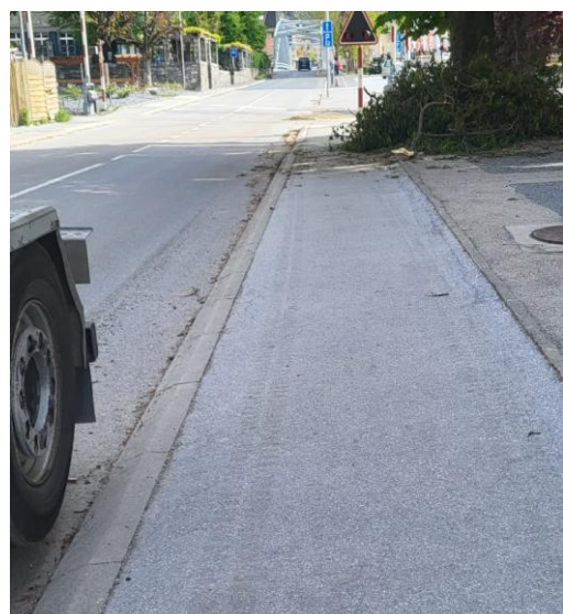
Figure 33 : Absence de bande cyclable du côté de la rue menant au pont de Chippis
