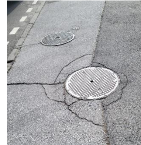
Figure 37 : Exemple de plaques d'égouts retrouvées le long du tronçon
