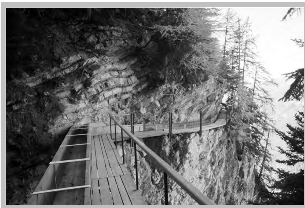
Planche XX Passerelle rénovée le long du tracé du bisse du Roh (Crans). Le canal n'a pas été remis en eau, contrairement à d'autres cas de restauration de bisses en Valais (Photo : E. Reynard, 1994)
